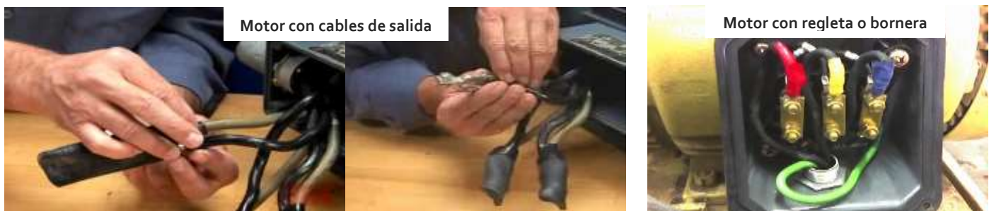
Figura. 2 Distintos tipos de motores en BT según la forma de conexión con la alimentación de potencia
