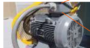
Figura. 1 Daño típico encontrado en la conexión de motores de BT
