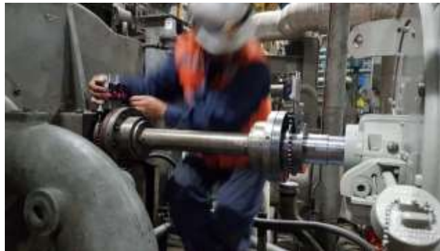
Figura 2 Procedimiento de alineamiento del motor con la máquina de carga (Cortesía de Ferroman S.A.-Chile)
