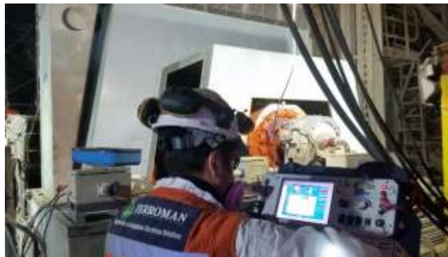
Figura 3 Ensayos dieléctricos durante la puesta en marcha de un motor (Cortesía de Ferroman S.A.-Chile)
