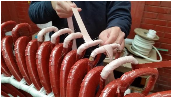
Figura 3 Proceso de rebobinado en motor de 13.8kV
