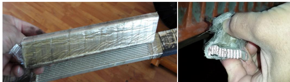
Figura 4 Inspección del devanado mostrando la falta de resina
