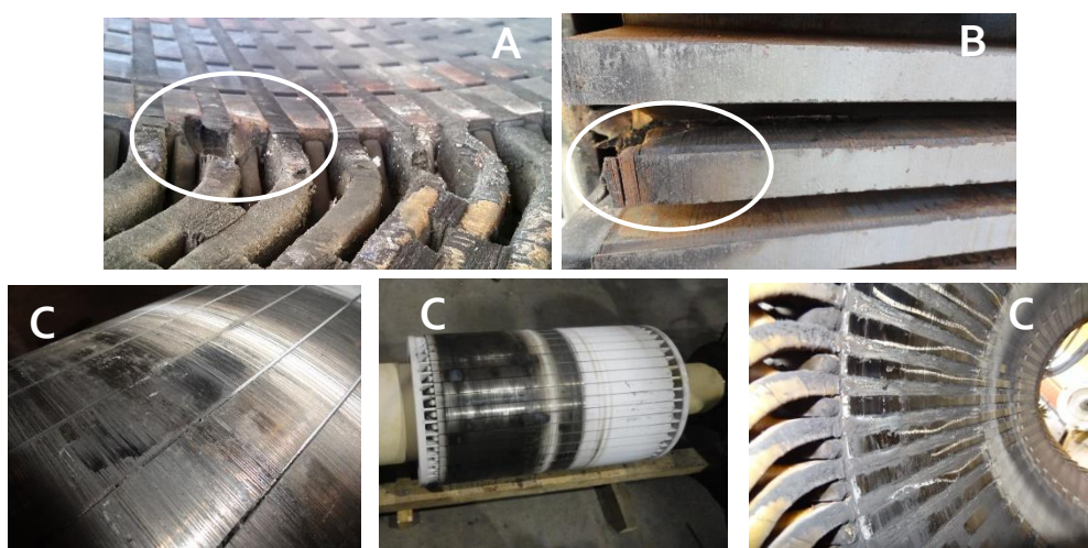
Figura 1 Daños típicos en núcleos magnéticos (Fuente: Ferroman S.A. – www.ferroman.cl )
