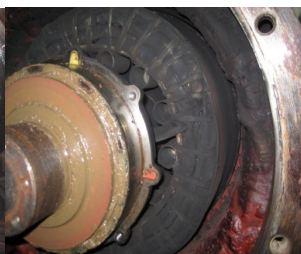
Falla de Lubricación
