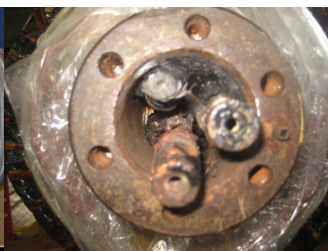
Falla Cables de Rotor
